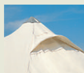
Entlüftungshaube im Dachbereich
